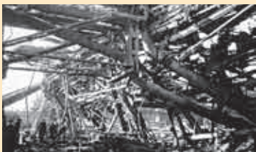
Naprostá devastace potrubních mostů
