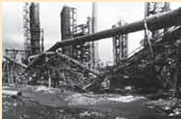
Zničené potrubí a potrubní mosty
