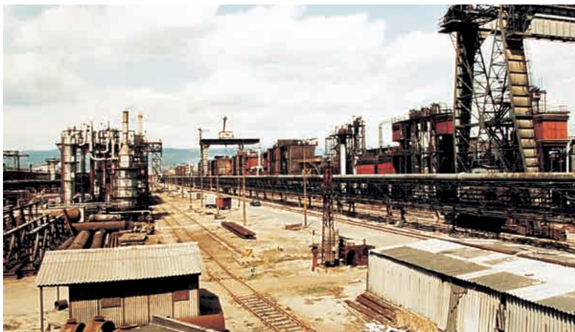
Hydrogenace po obnově - řada hydrogenáčnicích komor
