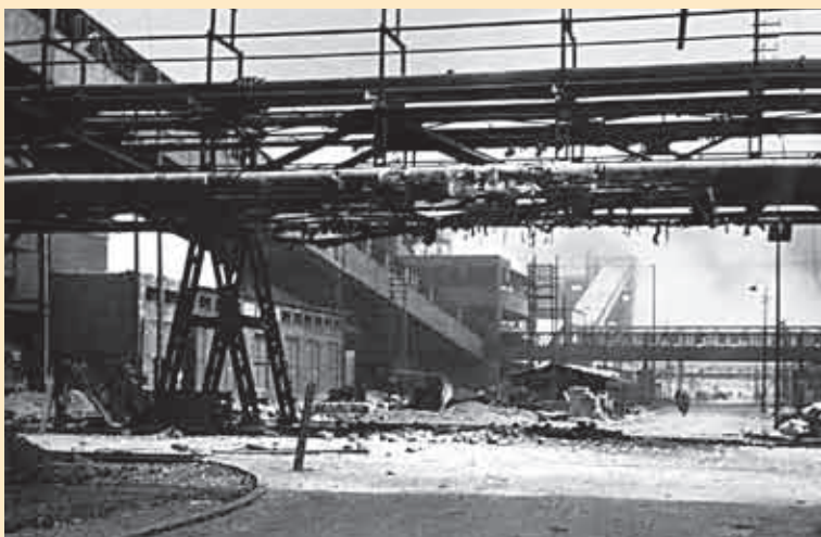
Poškozená přesýpací věž pasové dopravy uhlí – v pozadí dopravní most na plynárnu
