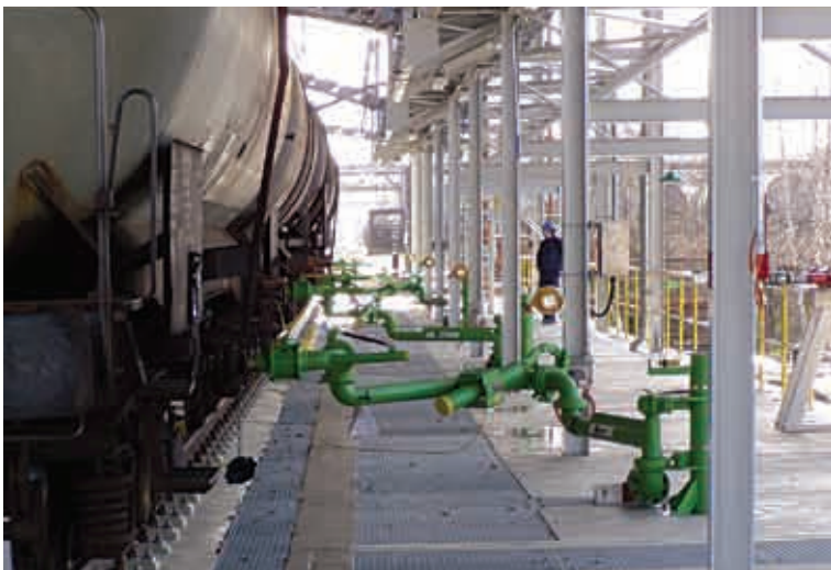
Pro příjem externích dodávek biokomponent bylo vybudováno speciální zařízení pro jejich stáčení z železničních cisteren.
