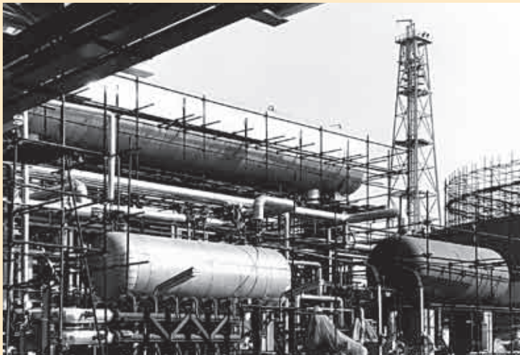
Sekce filtrace nástřiku - filtrace, nízkotlaký separátor a odlučovač vody
