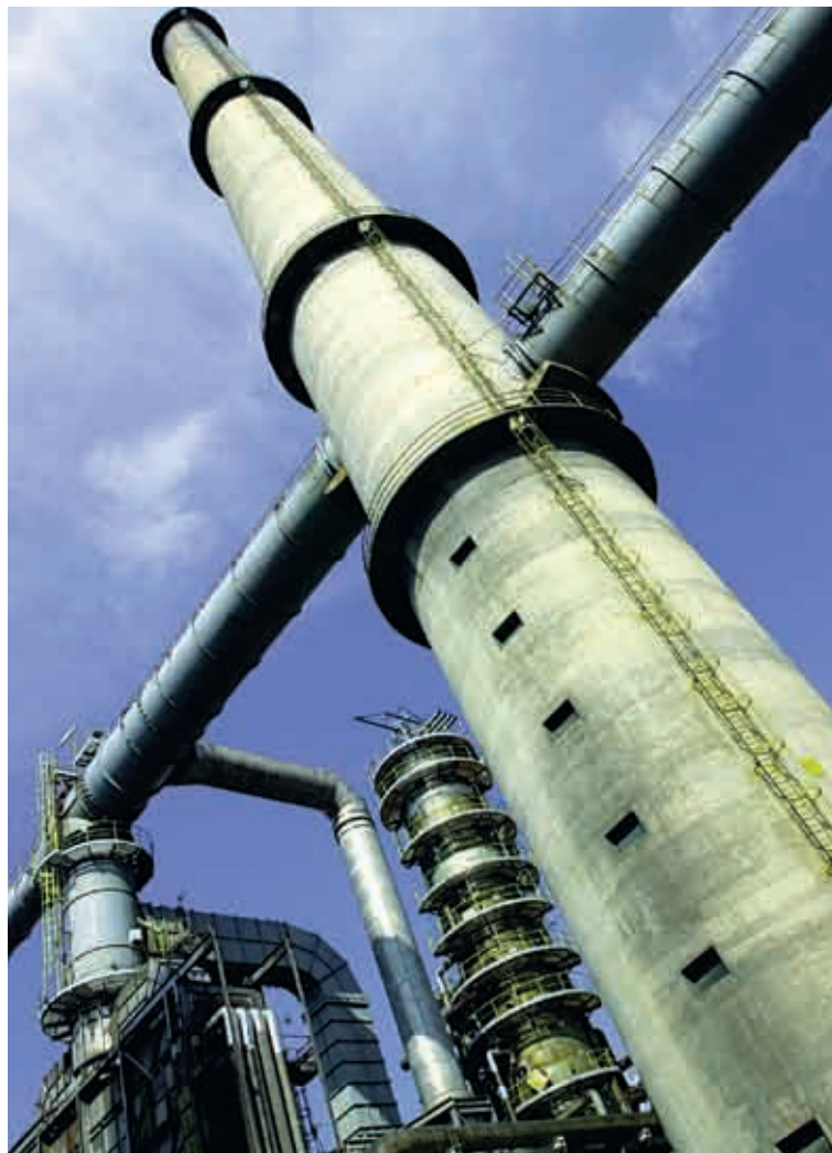
V rámci ochrany ovzduší bylo instalováno automatické monitorování spalin z pecí rafinérských procesů.
