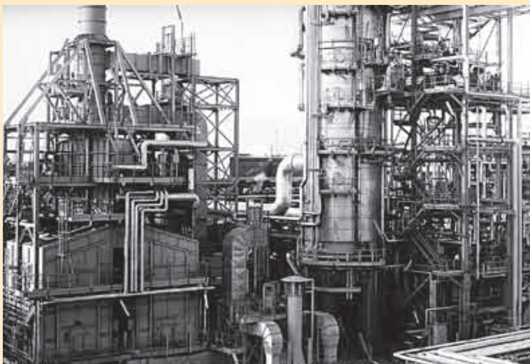
Pec a kolona vakuové destilace PSP
