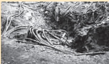
Zničené kabelové rozvody
