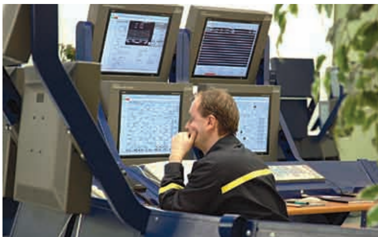
Nový centrální velin poskytuje moderní pracovní prostředí panelovým operátorům, kteří odtud řídí provoz všech rafinérských zařízení.
