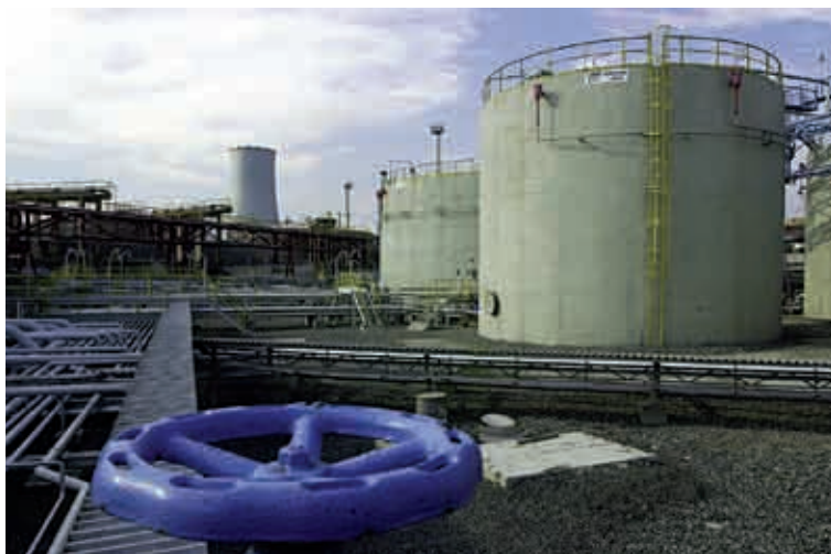
Zásobníky meziproduktů a četné potrubní rozvody
